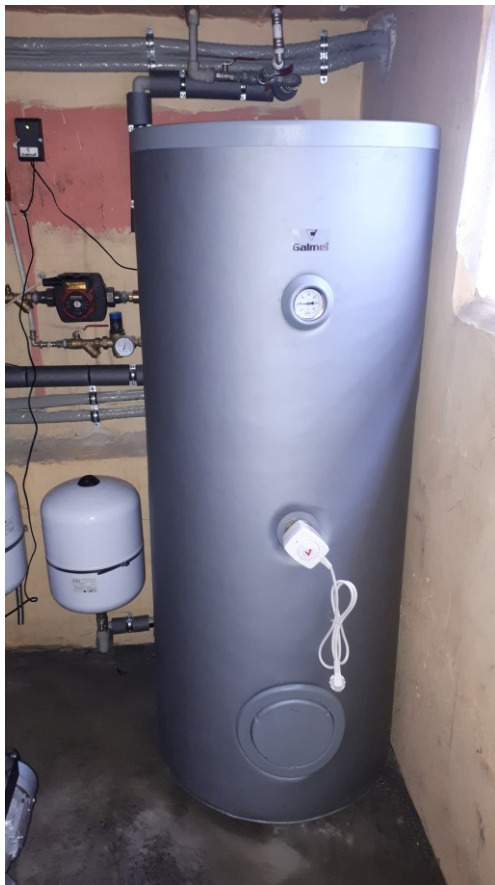
Pompa ciepła w budynku mieszkalnym
