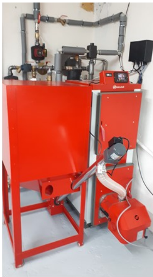
Kocioł na pellet w budynku mieszkalnym
